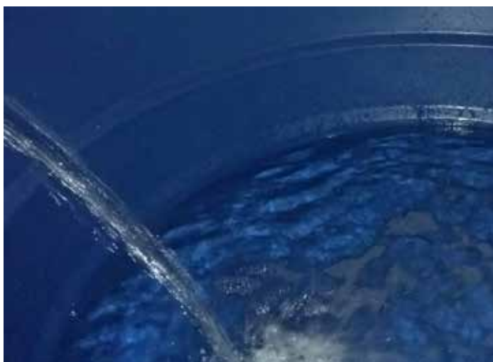
Água recolhida nos aparelhos de ar condicionados é levada para a caixa através de bomba
