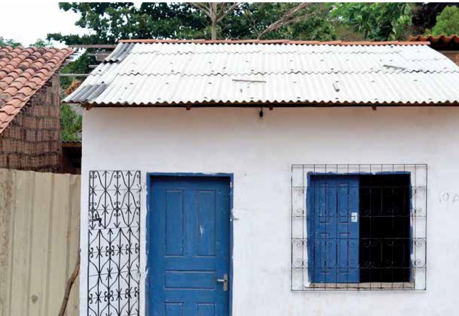
Telhado de zinco eleva a temperatura do ambiente e influencia o bem-estar dos moradores
